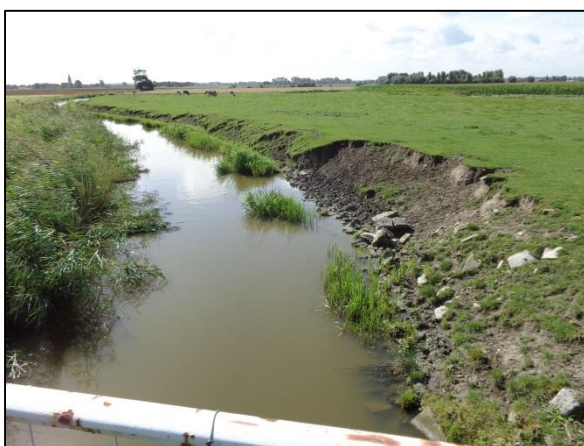
Foto: Oeverafkalvingen Blankenbergse vaart ter hoogte van N9 Oostendsesteenweg.
