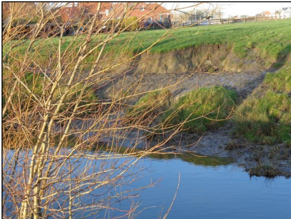
Foto: Instabiele oevers Blankenbergse vaart (zandinspoeling) opwaarts Meetkerke.
