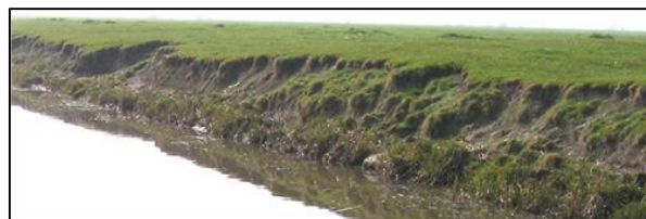
Foto: Detail sterke oeverafkalvingen stroomopwaarts aan de N9 Oostendsesteenweg.
