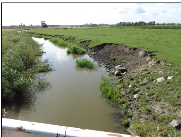
Foto: Oeverafkalvingen Blankenbergse vaart ter hoogte van N9 Oostendsesteenweg.
