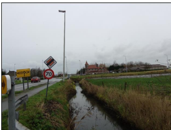
Foto: O.3.8.: Afgekalfde oevers een gevaarlijke situatie voor de infrastructuur.
