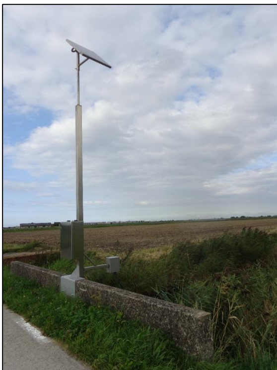
Figuur 41: Volledig geïnstalleerde meetinstallatie, gemonteerd op een kopmuur (P2).
