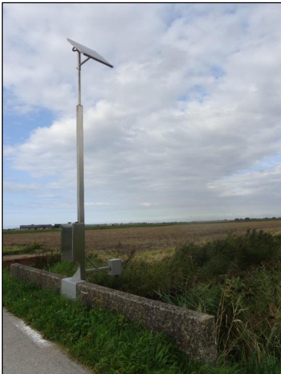
Figuur 33: Volledig geïnstalleerde meetinstallatie, gemonteerd op een kopmuur (P2).
