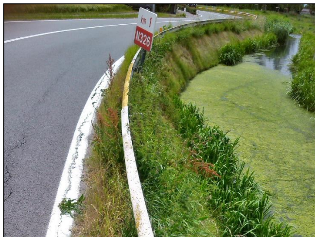
Figuur 13: Situatie voor de werken: afkalvende en onstabiele oevers, verzakking in gewestweg.
