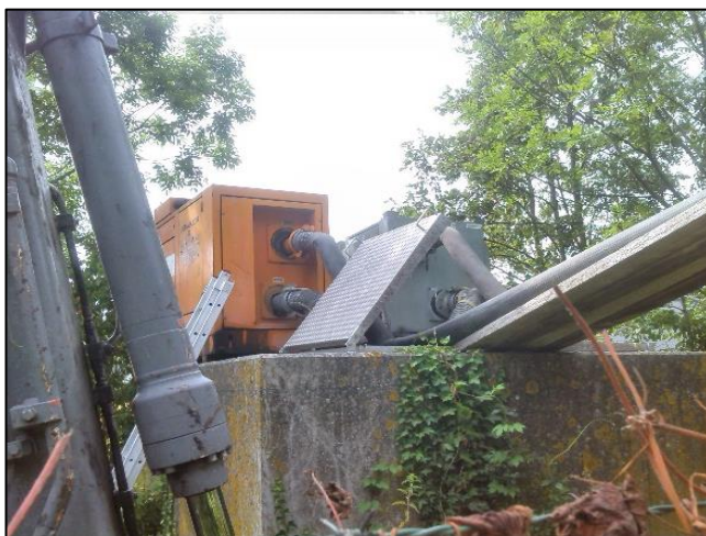
Figuur 19: Pompinstallatie effluentwater.
